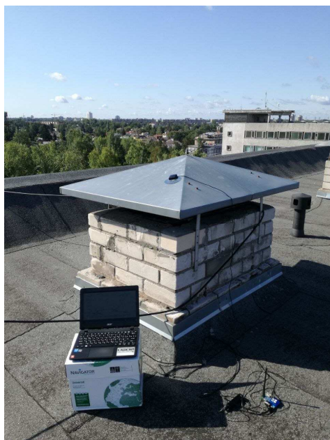
93. att. GNSS-RTK moduļu izmēģināšana uz EDI ēkas jumta pirms uzstādīšanas uz robota platformas
